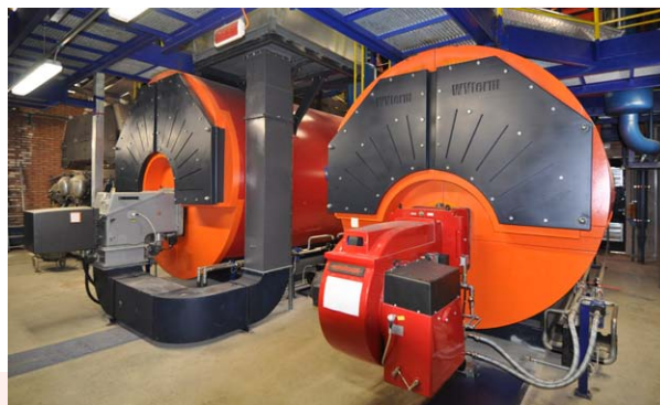
Nova vročevodna kotla nazivne moči 7 in 10 MW
