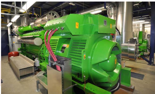
Nova motorja za soproizvodnjo (SPTTE) električne energije in toplote
